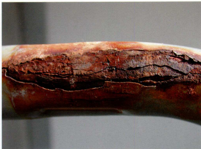
Очень сильная разъедающая коррозия на участке колена трубы. Элементы, инициирующие процесс коррозии: соли, сильные чистящие средства (кислотные), постоянная влажность.
