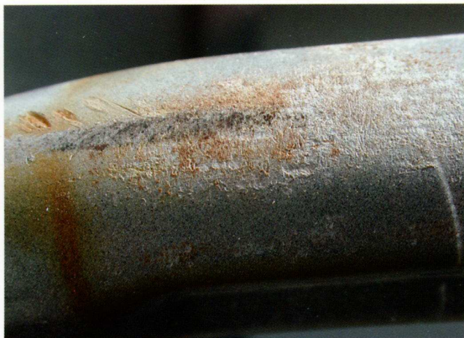
Истирание пленки покрытия на участке колена трубы
