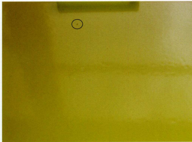
«Плевков» краски после отверждения покрытия.
